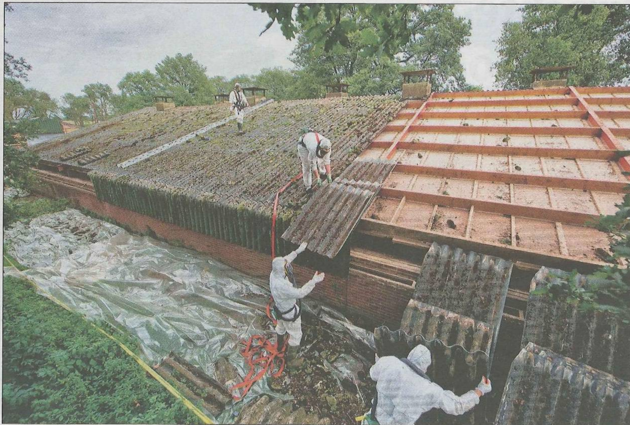
Mannen in witte pakken zijn bezig met astbestwerkzaamheden bij de boerderij aan de Veldboersweg 4 in Langeveen.
